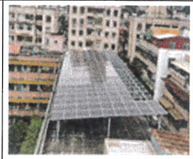
屋頂太陽能光電設備
